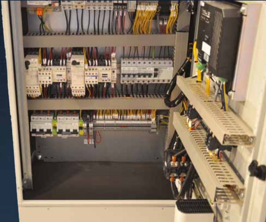
Widok otwartej szafy sterowniczej DC
